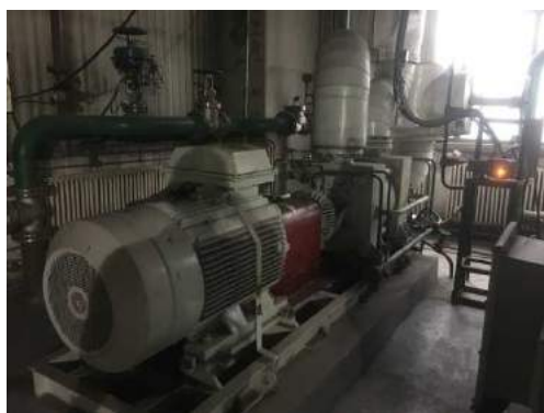
图 7 热网疏水泵图
