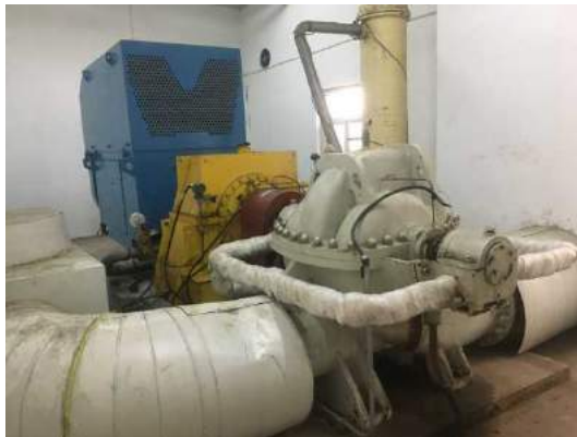
图 6 热网循环水泵图
